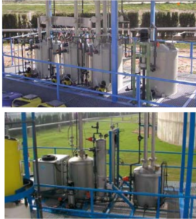
2. att. – Biogāzes attīrīšanas iekārta un CH 4 – CO 2 atdalīšanas iekārta
